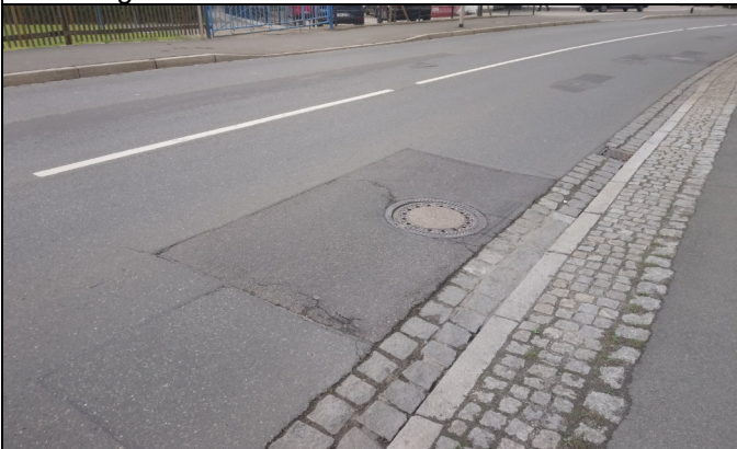
Fahrbahnzustand vor Gablenzer Hauptstraße Nr. 4, Stand 2018, Unstetigkeiten mit Pegelüberhöhungen bei Überfahrten, insbesondere durch LKW
