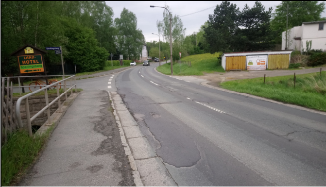
Fahrbahnzustand S 289 Einmündung Sperlingsberg, Unstetigkeiten mit Pegelüberhöhungen bei Überfahrten, insbesondere durch LKW
