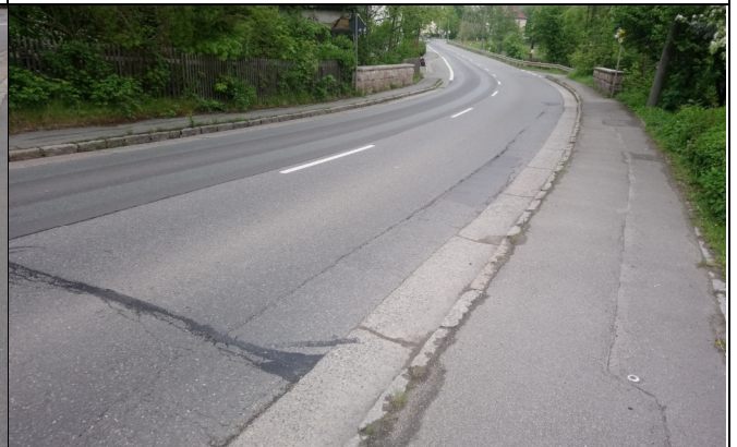
Fahrbahnzustand vor Gablenzer Hauptstraße Nr. 18, Stand 2018, Fahrbahneinbrüche mit Pegelüberhöhungen bei Überfahrten, insbesondere durch LKW
